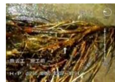
管内状況(木根侵入)
